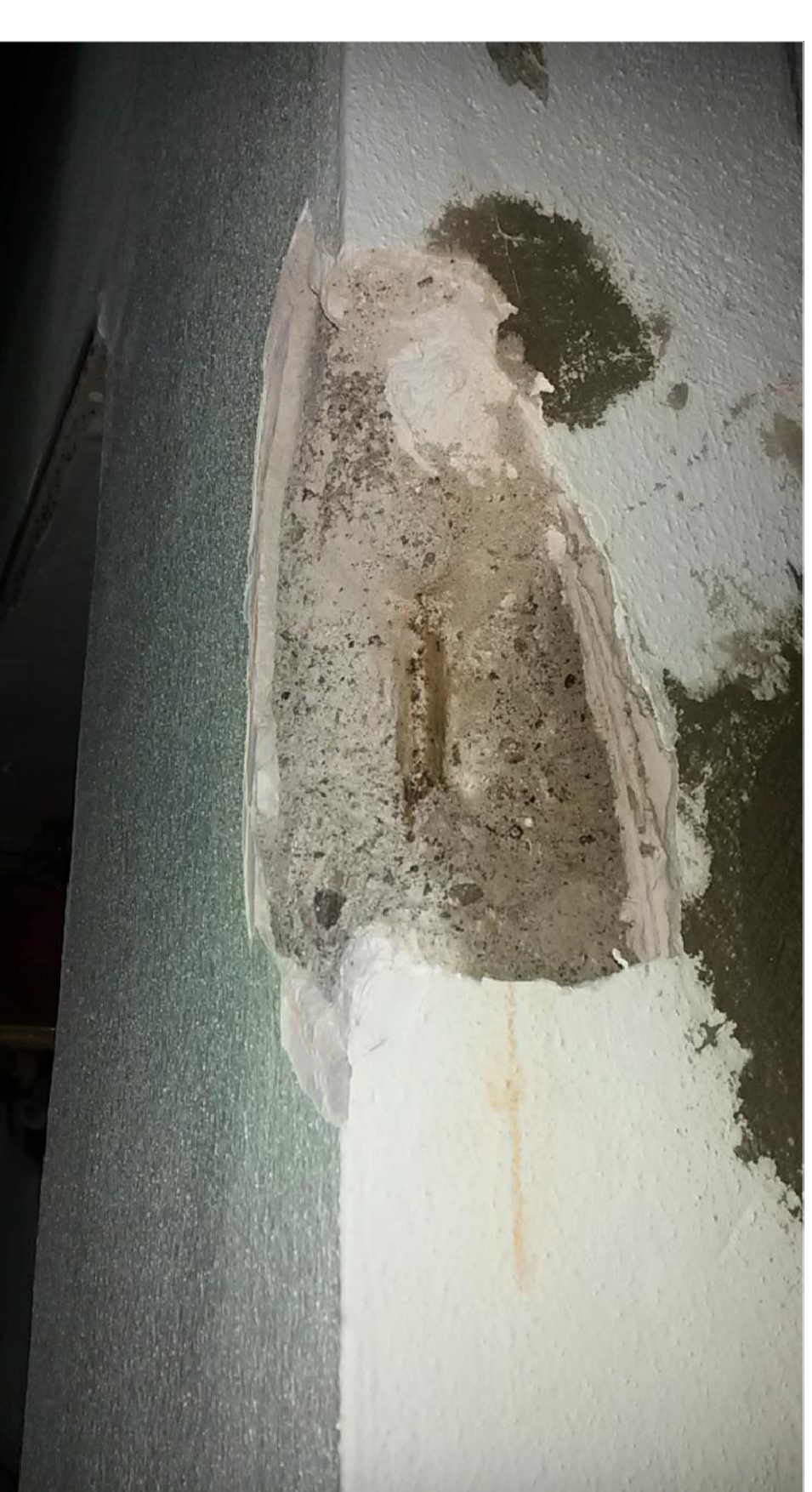
SAGGIO PILASTRO: STATO DI CONSERVAZIONE DELL'ARMATURA
