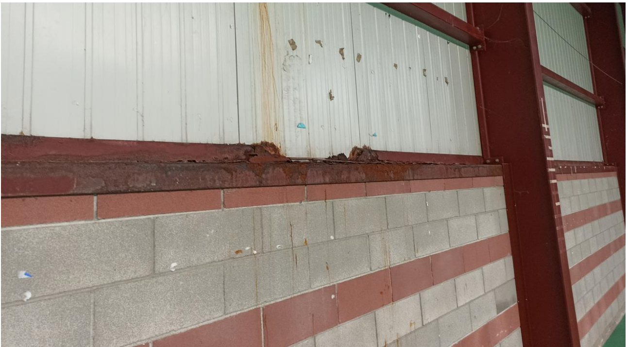
Struttura perimetrale, lato interno (ossidazione struttura metallica)
