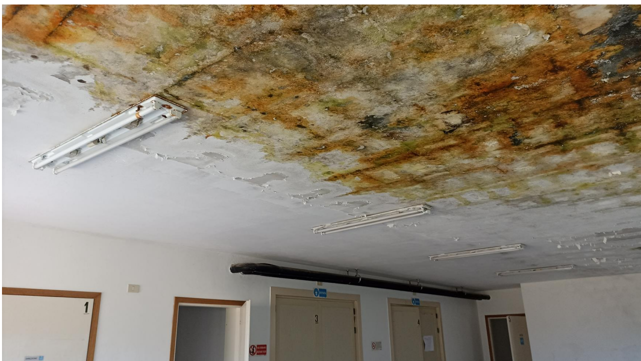
Soffitto locale disimpegno (accesso destro)
