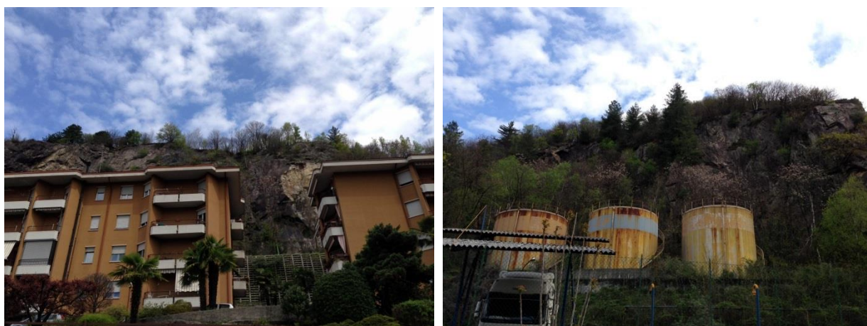
Foto: la parete rocciosa ubicata ai piedi della loc. Mina e a monte di via Creva. La parete presenta numerose fessurazioni ed è posizionata direttamente a monte di alcuni condomini, parzialmente protetti da reti paramassi. Esposto ad un eventuale crollo massi è anche l'ex deposito di oli minerali della ditta F.lli Dellea, le cui cisterne risultano vuote.
