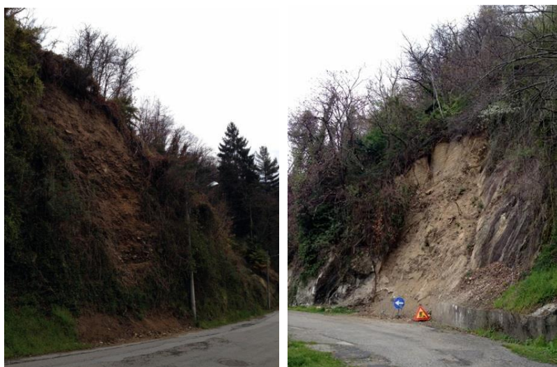
Foto sx: dissesto a ridosso della carreggiata di via Paolo Berra, a Colmegna, nelle vicinanze del cimitero 2013. Una riattivazione del dissesto appare possibile e interesserebbe di nuovo la sede stradale, pur con minore volumetria. Foto dx: dissesto a Colmegna – vicinanze Hotel Camin – strada posta sul retro della galleria
