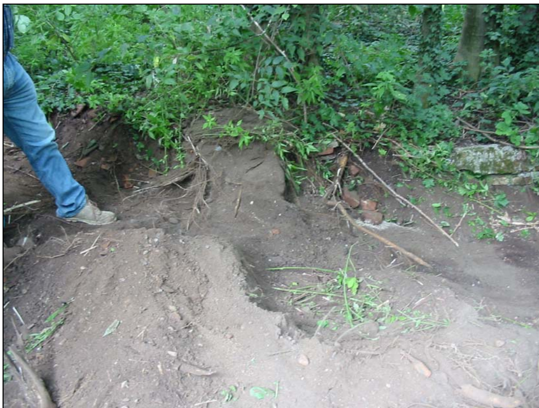
Foto 6 – Saggio S7 in corrispondenza del muretto in mattoni e malta che delimita la porzione Sud-est del Parco, poco più a Nord del saggio S6; in questo tratto gli alberi cresciuti sopra il muretto hanno praticamente demolito con le radici una parte del muro.
