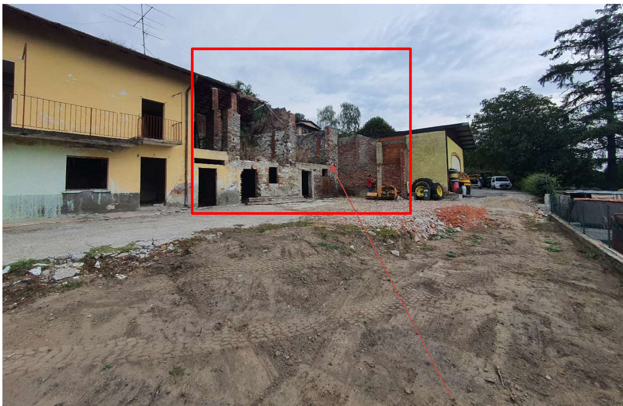
Ripresa Fotografica n. 4 – Lato Nord 3 – Porzione edificio crollata
