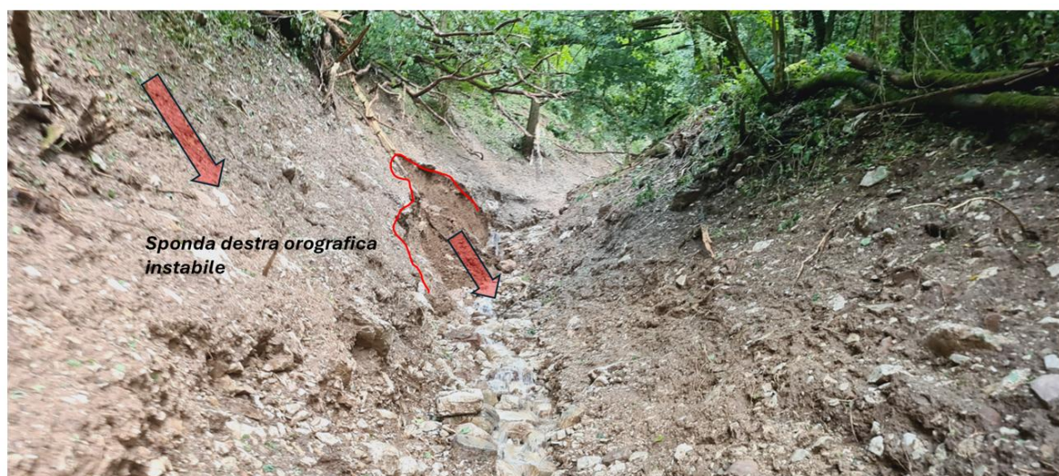
Fig. 11 primi segni di instabilità delle sponde conseguenti l'erosione di fondo.
