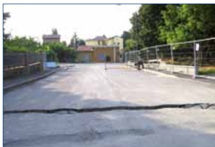
Figura 7.8: Distorsione differenziale pavimentazione stradale (terremoto Emilia-Romagna 2012)
