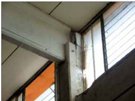
Figura 5.21: Danneggiamento della forcina del pilastro, dotata di perno di collegamento, in corrispondenza della trave. Livello di danno nella connessione trave-pilastro: D4 (terremoto Emilia-Romagna 2012, San Felice sul Panaro, MO)
