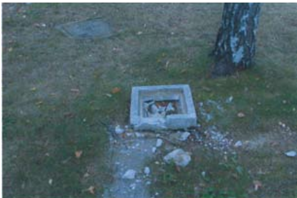
Chiusino “rimosso” e “demolito”
