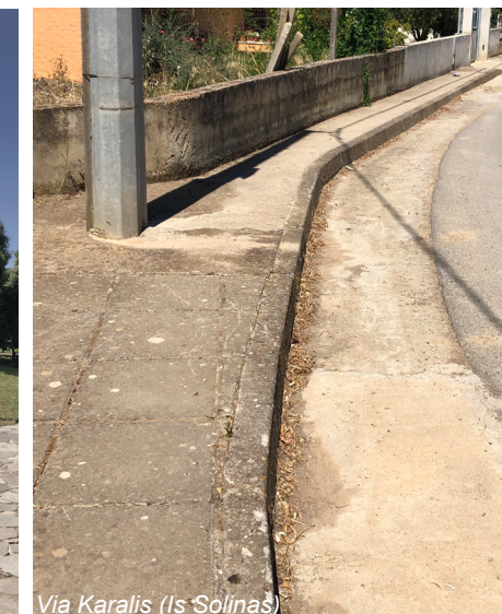
Via Karalis (Is Solinas) STATO ATTUALE - PAVIMENTAZIONE IN CEMENTO
