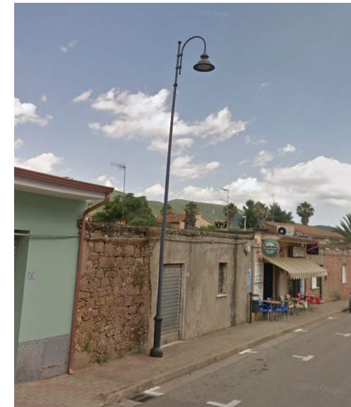
Corpo Illuminante Tipo B (Strade centro storico e piazza chiesa)
