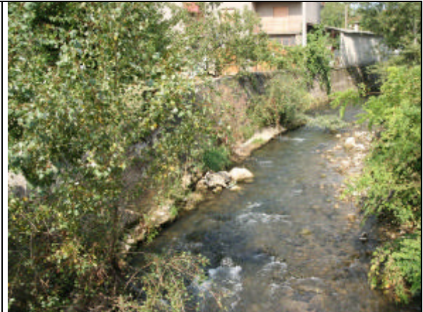
Erosione della sponda del Cherio poco prima della confluenza del Valzello
