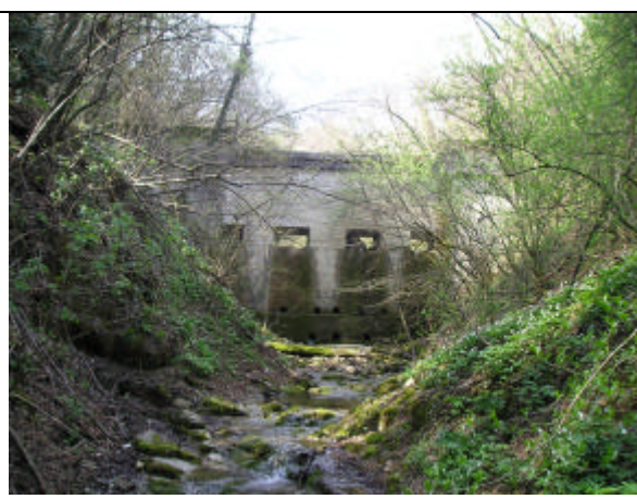
Briglia selettiva in calcestruzzo in valle Closale
