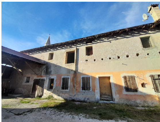
Esempi di facciate in cui sussistono le condizioni per riproporre fedelmente il colore originario.
