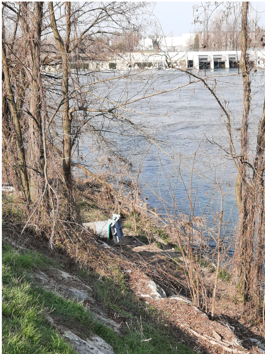
(foto n.14 - valvola a Clapet di valle)
