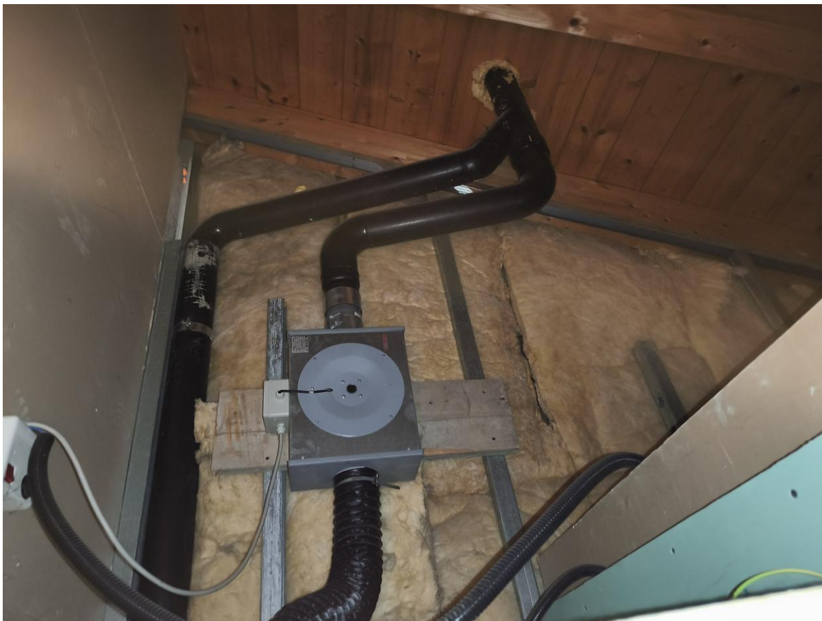
Figura 6 –scuola dell'infanzia copro B– controsoffitto bagni – sistema di aspirazione
