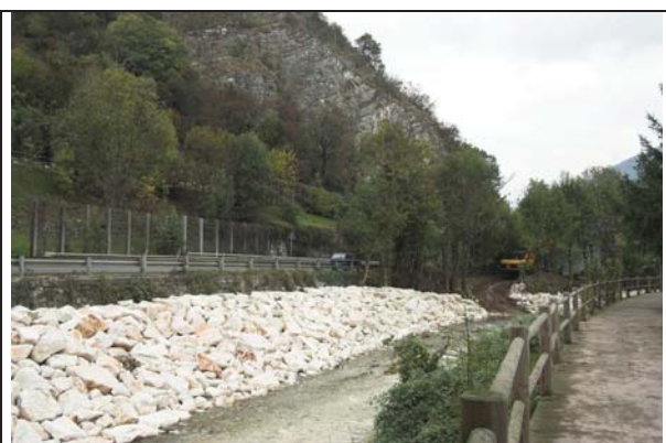
Barriera paramassi e massicciata spondale lungo via Nazionale in località Martina
