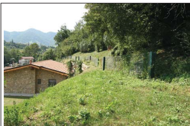
Barriera paramassi a monte di via Martina
