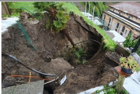
Frana a monte dele centrale di Creva – 2024 fonte: Luinonotizie
