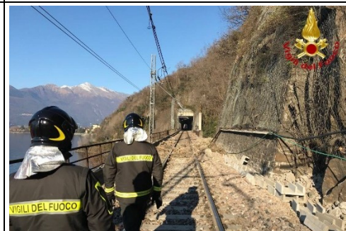
Frana lungo la ferrovia nel tratto verso Maccagno – 2018 - VVF
