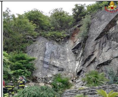
Frana a monte di via Creva. Distacco del 06/2016 - VVF
