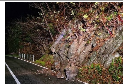
crolli massi lungo la SS344Dir – lungo Tresa – 2022
