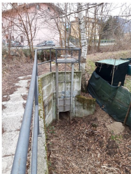
Figura 65. Manufatto per lo scarico delle acque di sgrondo dei terreni posti a tergo degli argini.
