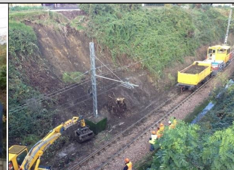
Foto – Frana Germignaga su ferrovia – 2014 –fonte varesenews
