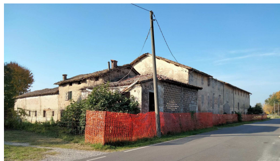
Fabbricato rurale collabente
