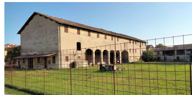
Fabbricato rurale collabente
