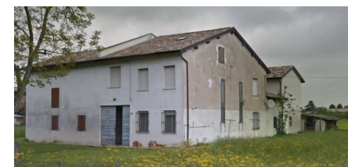
Edificio residenziale in cattivo stato di conservazione
