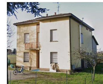
Fabbricato residenziale in cattivo stato di conservazione
