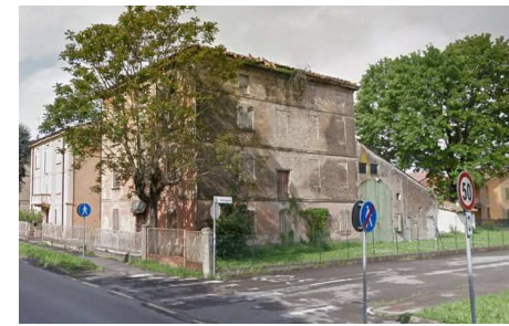
Edilizia residenziale storica in cattivo stato di conservazione
