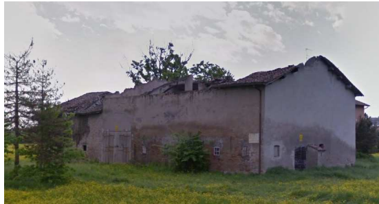
Fabbricato rurale collabente
