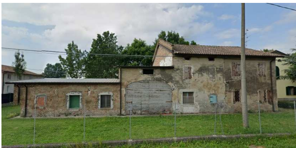
Edificio rurale in cattivo stato di manutenzione
