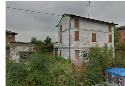
Edilizia residenziale storica in cattivo stato di conservazione
