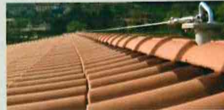
Esempio di dispositivo di sicurezza "linea vita"
